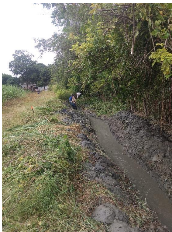
Foto 2: Mantenimiento Acequia Pekín dentro del predio la permuta para darle velocidad al agua, para que no sedimente la tubería que están destapando en el callejón santarita
