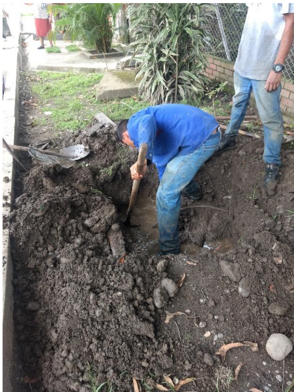
Foto 1: Sector callejón santa rita junto al aeropuerto farfán, destapando tubería para encontrar la obstrucción que hay al interior de la acequia.
